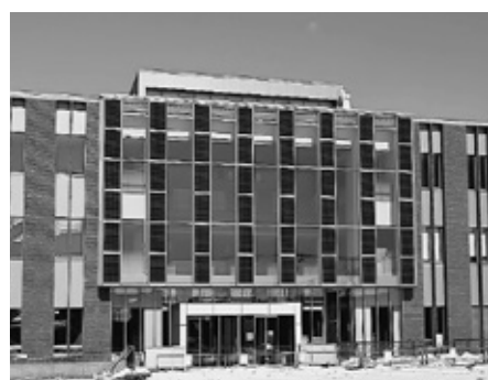
役場庁舎南側壁面の 太陽光パネル
