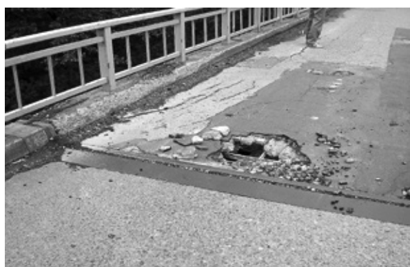
本年6月、穴の開いた道道栄橋の様子
