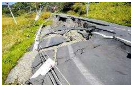
平成 15 年十勝沖地震（豊頃町）
