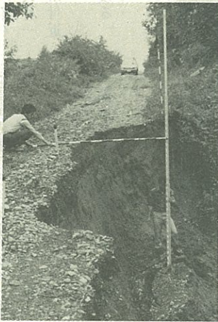
路肩が崩れ通行不能となった古舞9線道路▶
