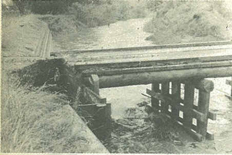
▼取り付け部分が崩れた千住14号橋
