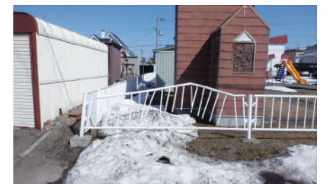
▲ 町内の公園にある柵の被害状況
