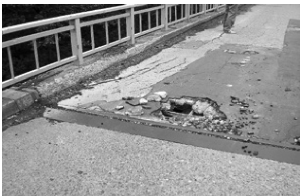
本年6月、穴の開いた道道栄橋の様子
