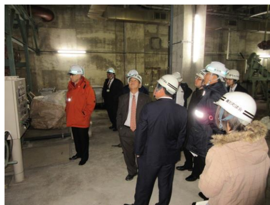
札幌中継ポンプ場（札幌春日町）
