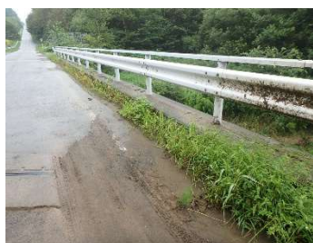
橋面土砂堆積
