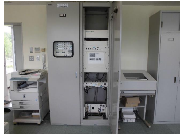
④音声拡幅器（管理棟内）
