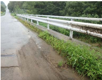
橋面土砂堆積
