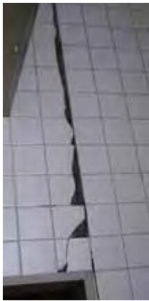
▲庁舎5階のひび割れ
