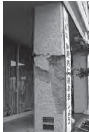
▲庁舎1階の柱がせん断破壊
