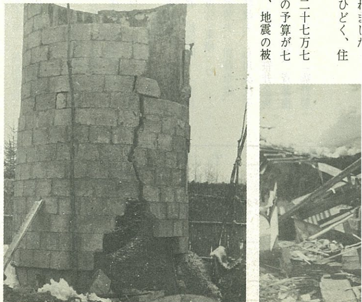
十勝沖地震で壊れたサイロと住宅
